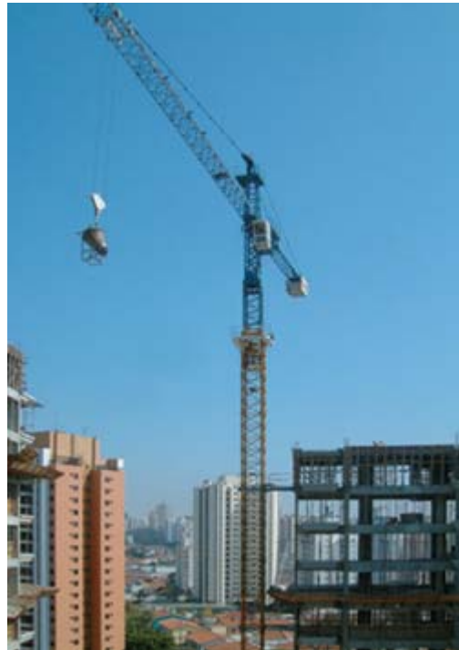
Planejamento logístico do canteiro deve prever a capacidade técnica e o espaço disponível para a locomoção de grandes equipamentos
