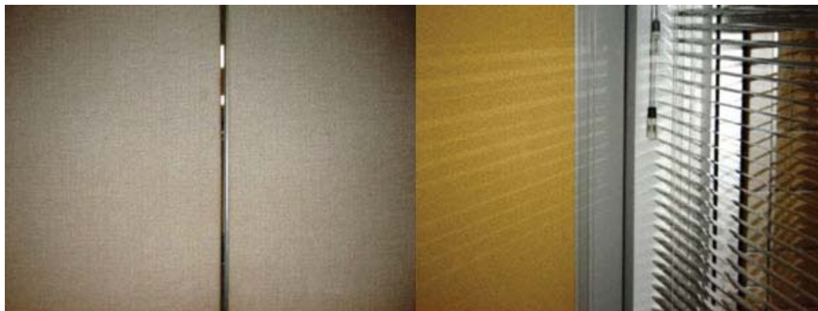
À esquerda, figura 2, fresta entre painéis de divisória articulada. À direita, figura 3, fresta entre divisória e alvenaria.
